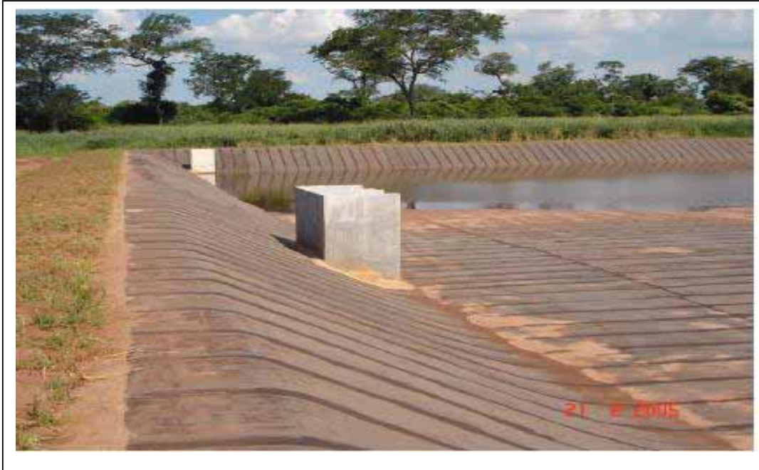
Fig 06 – Reservorio de vinaza revestido con asfalto
